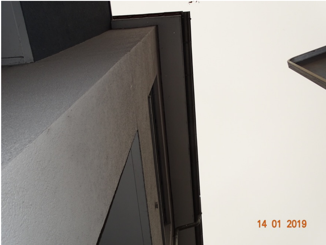
Abb. 10: Außenfassade Bereich IX, der ca. 2 cm breite Spalt an der Traufe ist vergittert und bietet keinen Zugang für Fledermäuse oder Vögel
