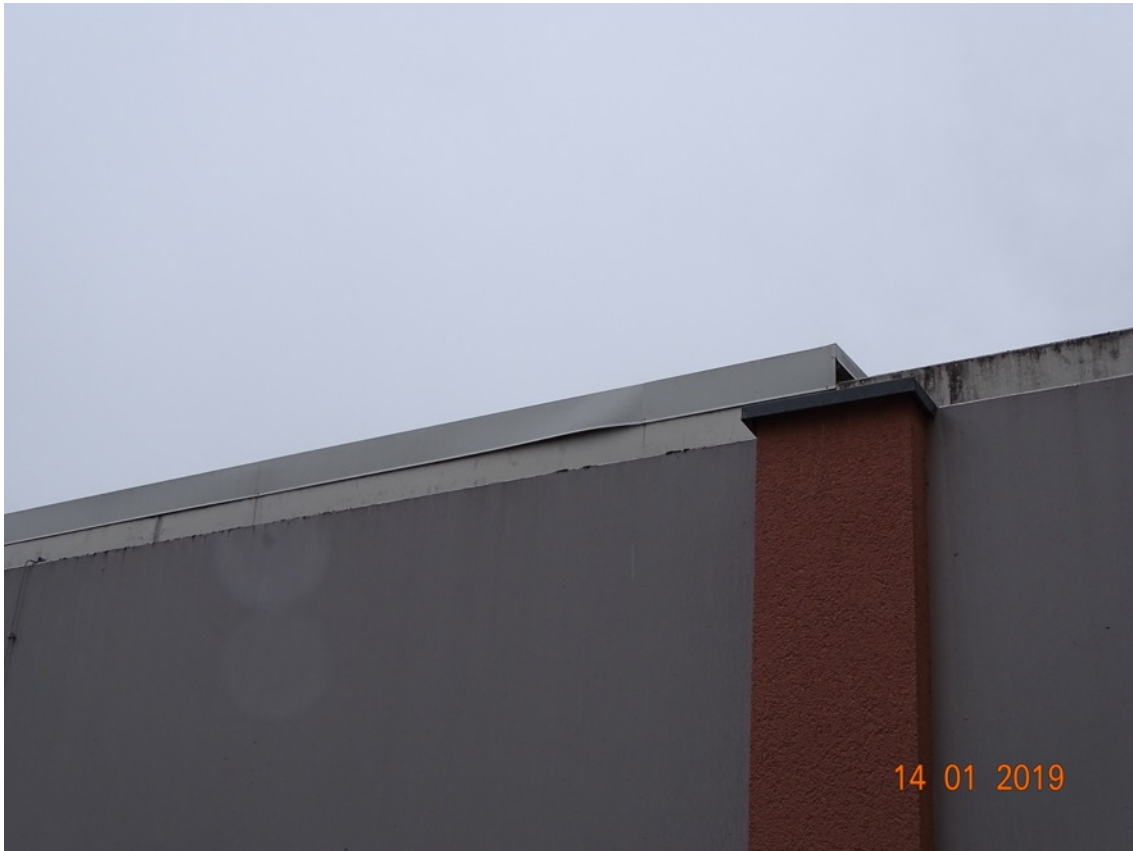
Abb. 11: Außenfassade Bereich X, die Fassadenflächen bieten kein Spaltenangebot, das ca. 30 cm hohe Dachabschlussblech ist an mehreren Stellen aufgebogen, die Spalten könnten Fledermaushangplätze bieten
